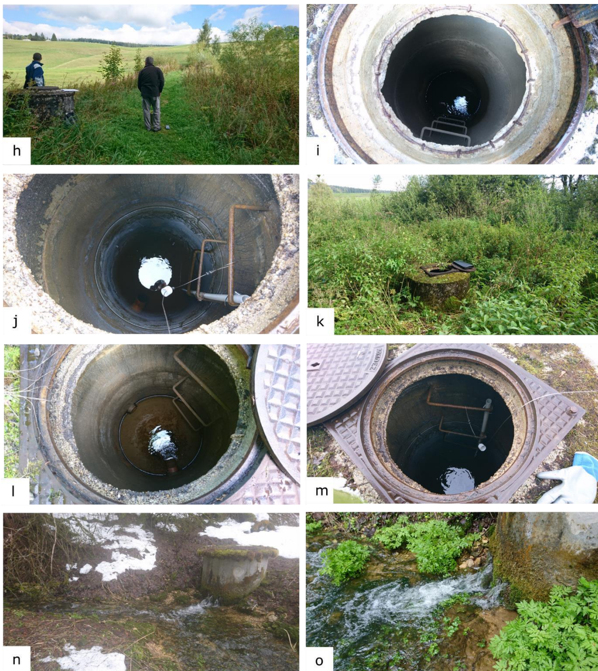
Annexe 4 : Photos des captages et systèmes de surveillance des sources. h) Chambre de captage de la Combe Nord, i) Chambre de captage de la Combe Nord en période d'étiage avec le tuyau des drains à l'air, j) Chambre de captage de la Combe Nord en hautes eaux avec les drains submergés, k) Chambre de captage de la Combe Centre, l) Chambre de captage de la Combe Centre en période d'étiage avec le tuyau des drains à l'air, m) Chambre de captage de la Combe Centre en hautes eaux avec les drains submergés, n) A droite chambre de captage de la Combe Sud et à gauche source temporaire de la Combe Sud, o) Trop-plein actif et fuite du captage de la Combe Sud.
