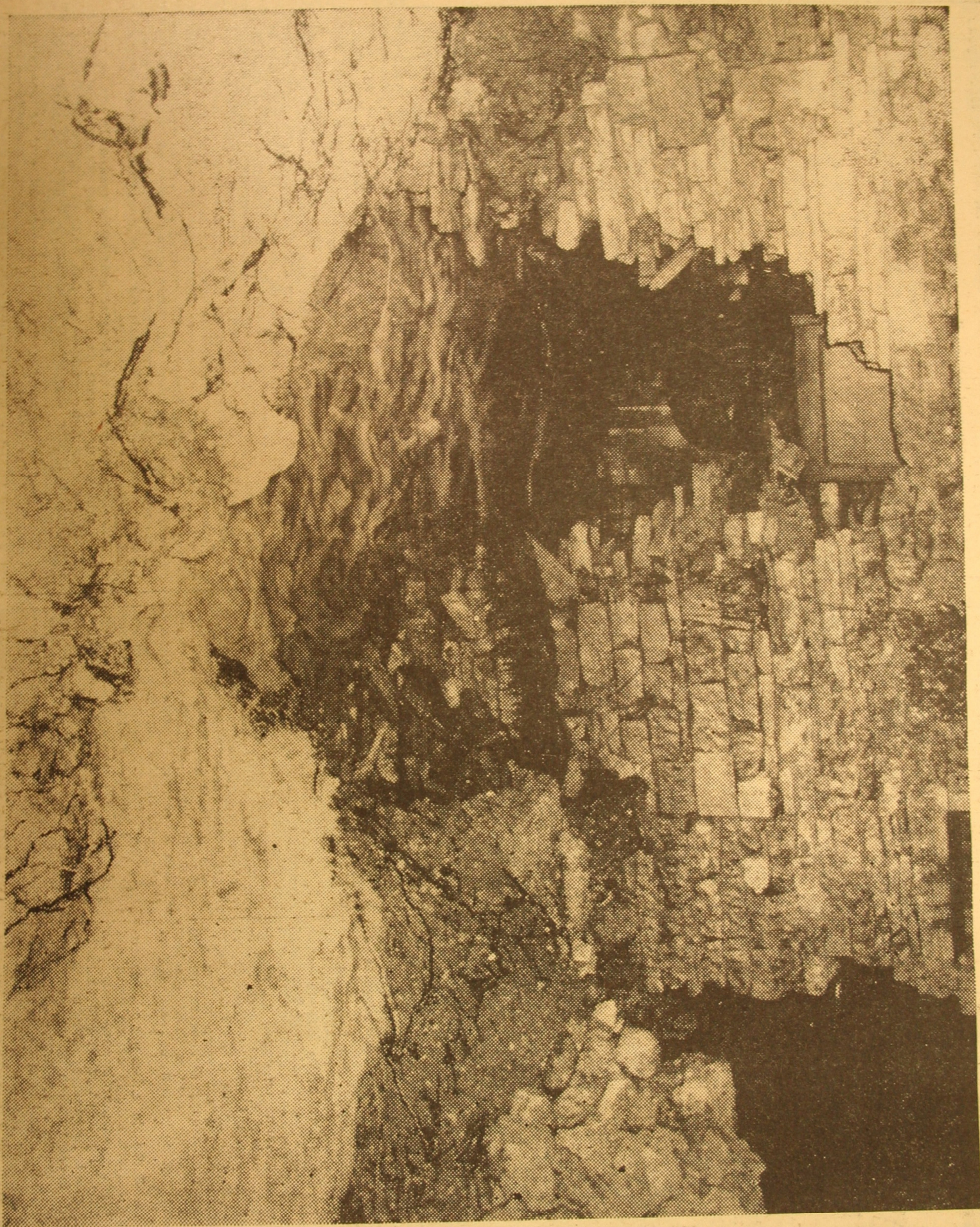
Des brèches gigantesques se sont ouvertes dans les murs des habitations
