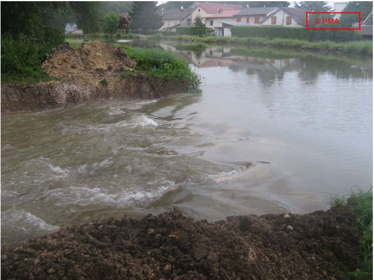
« Brèche ouverte à Voujeaucourt »
