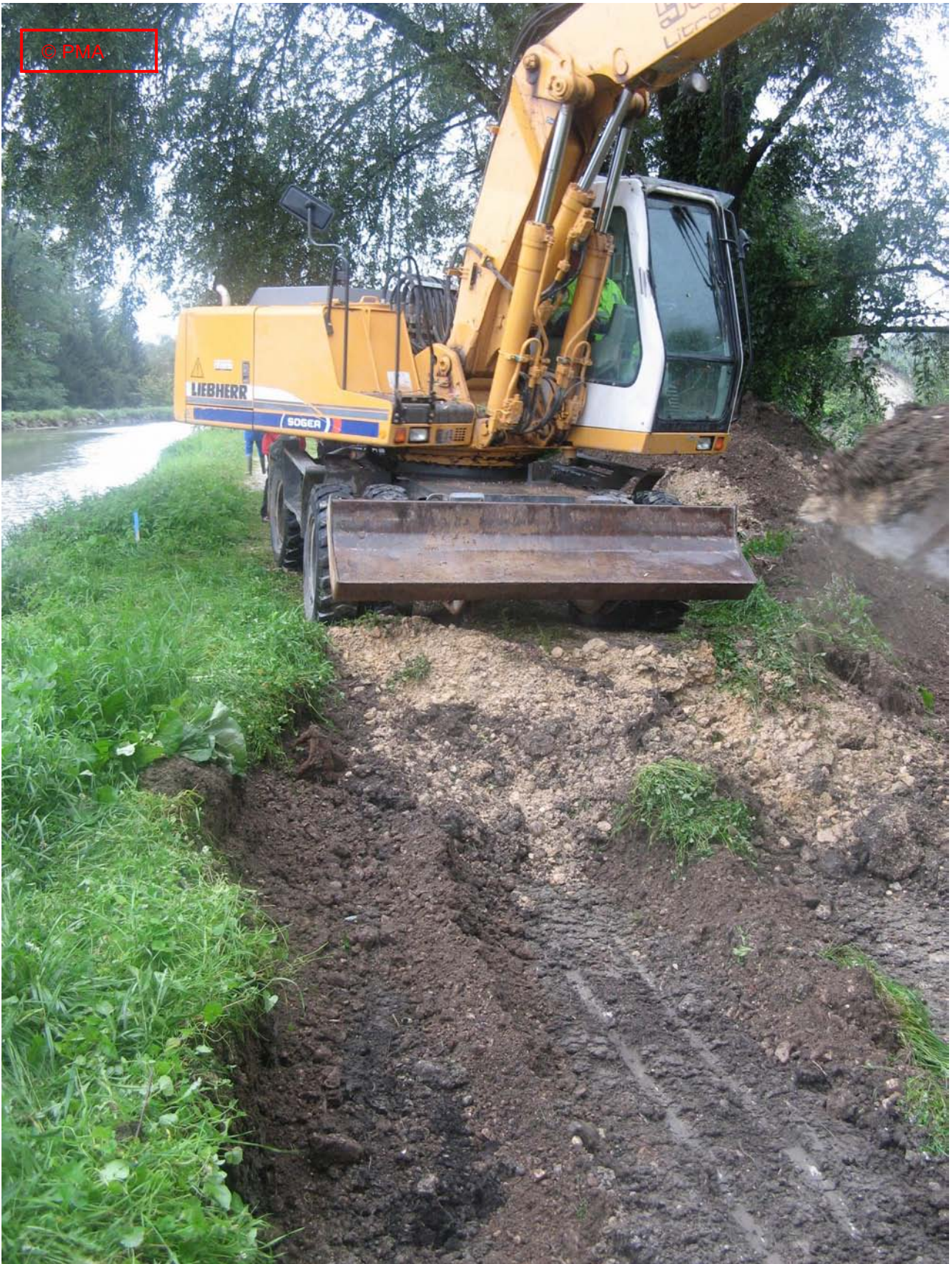
« Brèche ouverte à Voujeaucourt »
