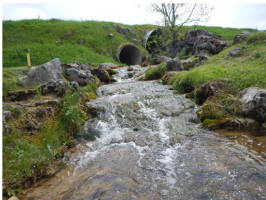
(a) Obstacle à la continuité écologique, situé au niveau de la RD29E1
